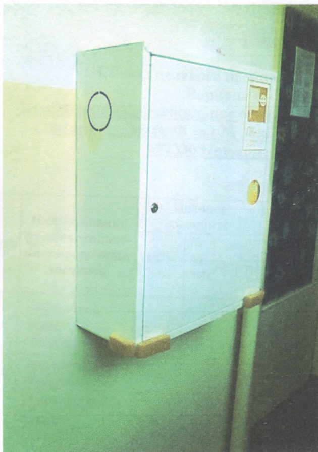
Фото № 8 Пожарный ящик
